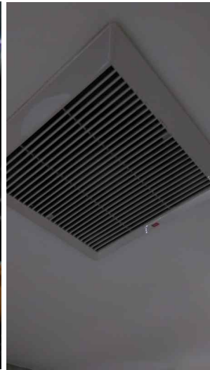
Ventilation fan cleaning
